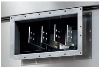
LV Cable Box
